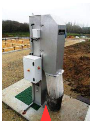
Dégrilleur de la station d'épuration
